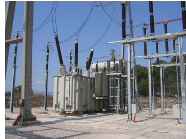
Subestación transformadora para líneas de MAT (132 a 400 kV)
