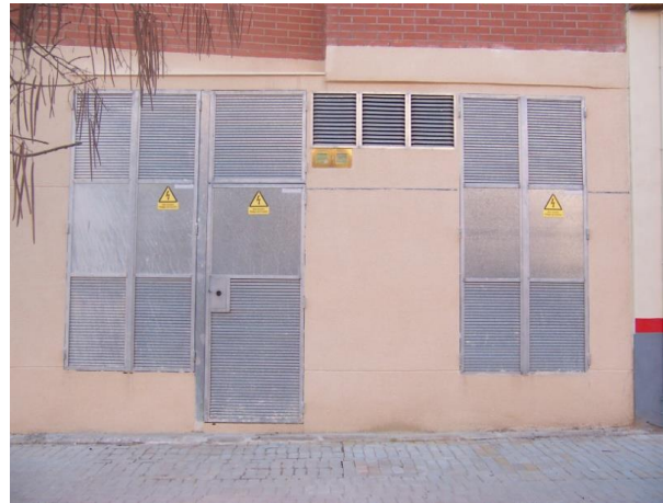
Centro de transformación (CT) de 20 kV (subterránea) a 400 V (trifásica)/230 V (monofásica)
