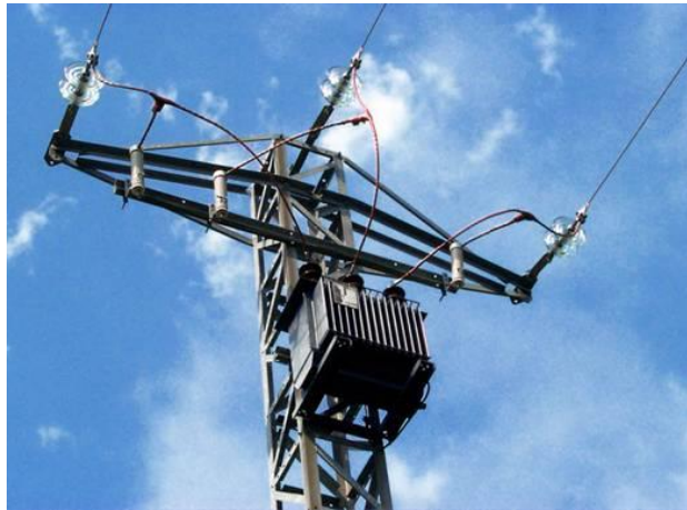
Transformador de 20 kV (aérea) a 400 V (trifásica)/230 V (monofásica)
